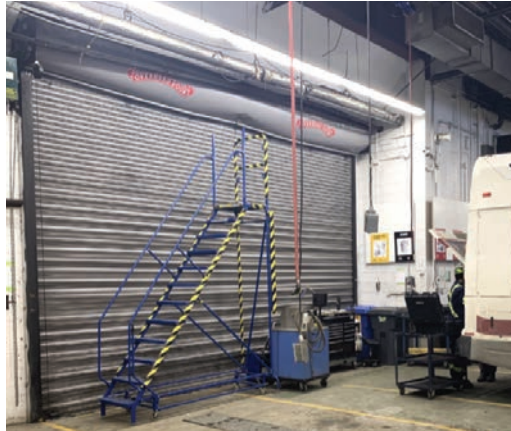
Garage de Saint-Hubert - côté garage mécanique : la porte coupe-feu n'ouvre plus.
