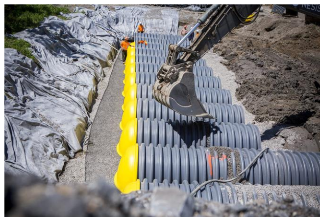
Conduites de rétention souterraines
