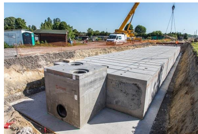
Réservoirs de rétention souterrains
