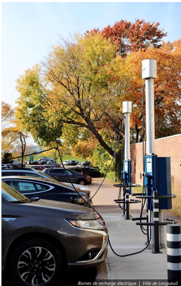
Bornes de recharge électrique | Ville de Longueuil
